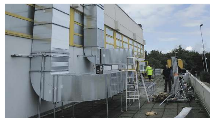
In Mensa und Pädagogischem Zentrum der Gustav-Heinemann-Gesamtschule wurden Akustikpanels (oben) installiert. Eine Belüftungsanlage sorgt für einwandfreie Bedingungen in der sanierten Sporthalle der Schule, die auch von zahlreichen Vereinen genutzt wird.
